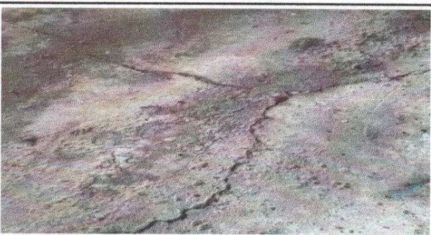
Foto 5: Sustrucción de piso de torta de concreto
