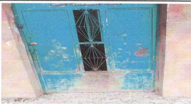
Foto 3: Sustrucción de puerta
